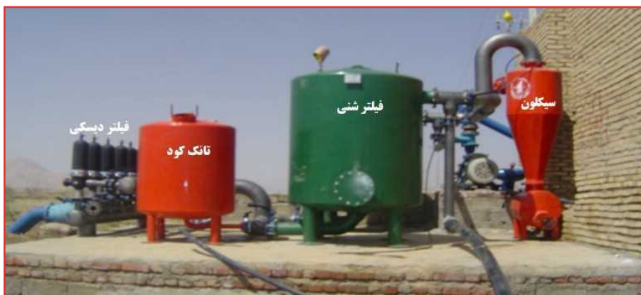
شکل ۳- نمایی از ایستگاه کنترل مرکزی
