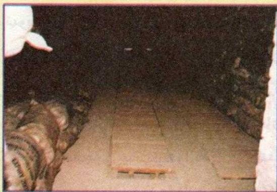
کانالهای تهویه هوا در کف انبار
