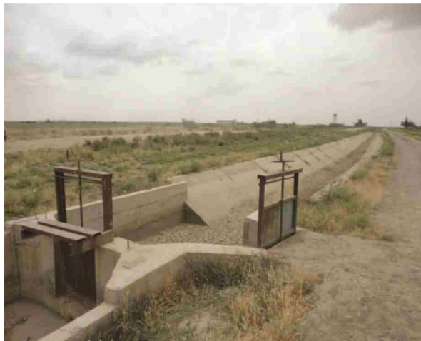
شکل ۱۱- نمایی از سازه‌های توزیع آب برای برداشت مقدار مشخص آب از کانال
