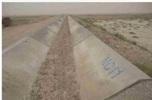
شکل ۲- نمایی از کانال‌های انتقال آب برای آبیاری با پوشش (بتنی)
