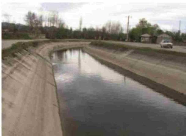
شکل ۲۷- ب: کانال بتنی برای انتقال آب
