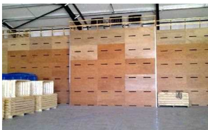
شکل ۲۲- دیواره‌های مکش تعبیه شده در انبار سیب‌زمینی برای تضمین تهویه لایه‌لای کل محصول
