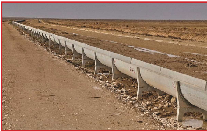
شکل ۱۵- کانال نصب شده
