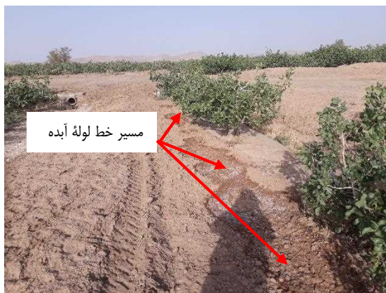
تصویر ۱۹- آثار به‌جا مانده از فشار هیدرواستاتیک در پروفیل خاک و جاری شدن آب در سطح زمین در یکی از باغ‌های تجهیز شده به آبیاری زیرسطحی کم‌فشار در منطقه نوق
