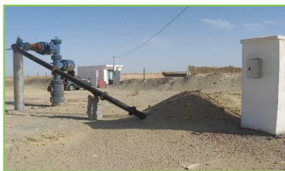
لوله استخراج آب داغ از اعماق زمین
