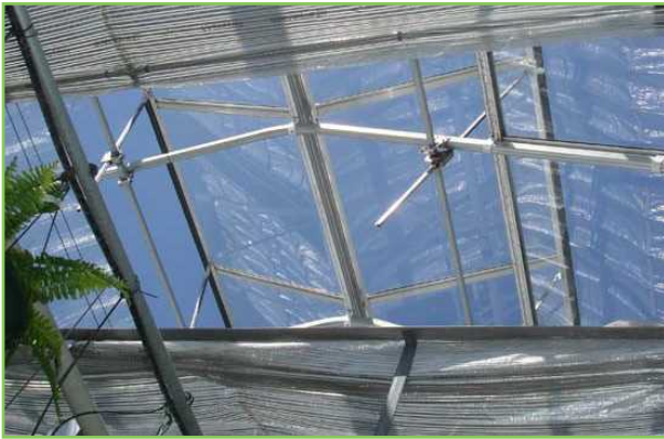
شکل ۲۱- پرده ذخیره انرژی نصب‌شده در گلخانه
