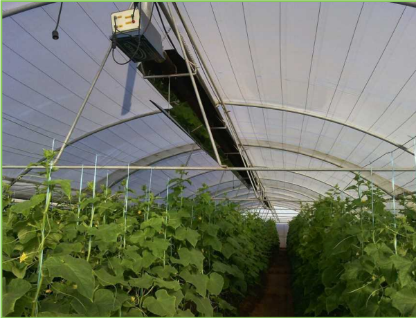
شکل ۳۰- به‌کارگیری گرم‌کن‌های تابشی برای گرمایش گلخانه در پاکدشت
