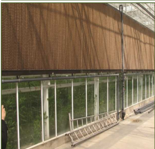
شکل ۲۳: نمونه‌یی از سیستم سرمایش تبخیری پد- فن نصب شده در گلخانه‌ها (بالا) و جریان چرخش آب در سیستم سرمایش تبخیری پد - فن نصب شده در گلخانه‌ها (پایین)
